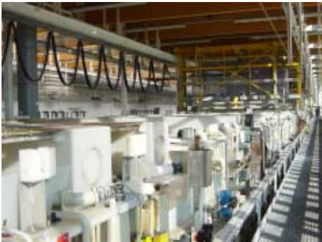
Abbildung 6-11: Eloxalanlage im Werk II
