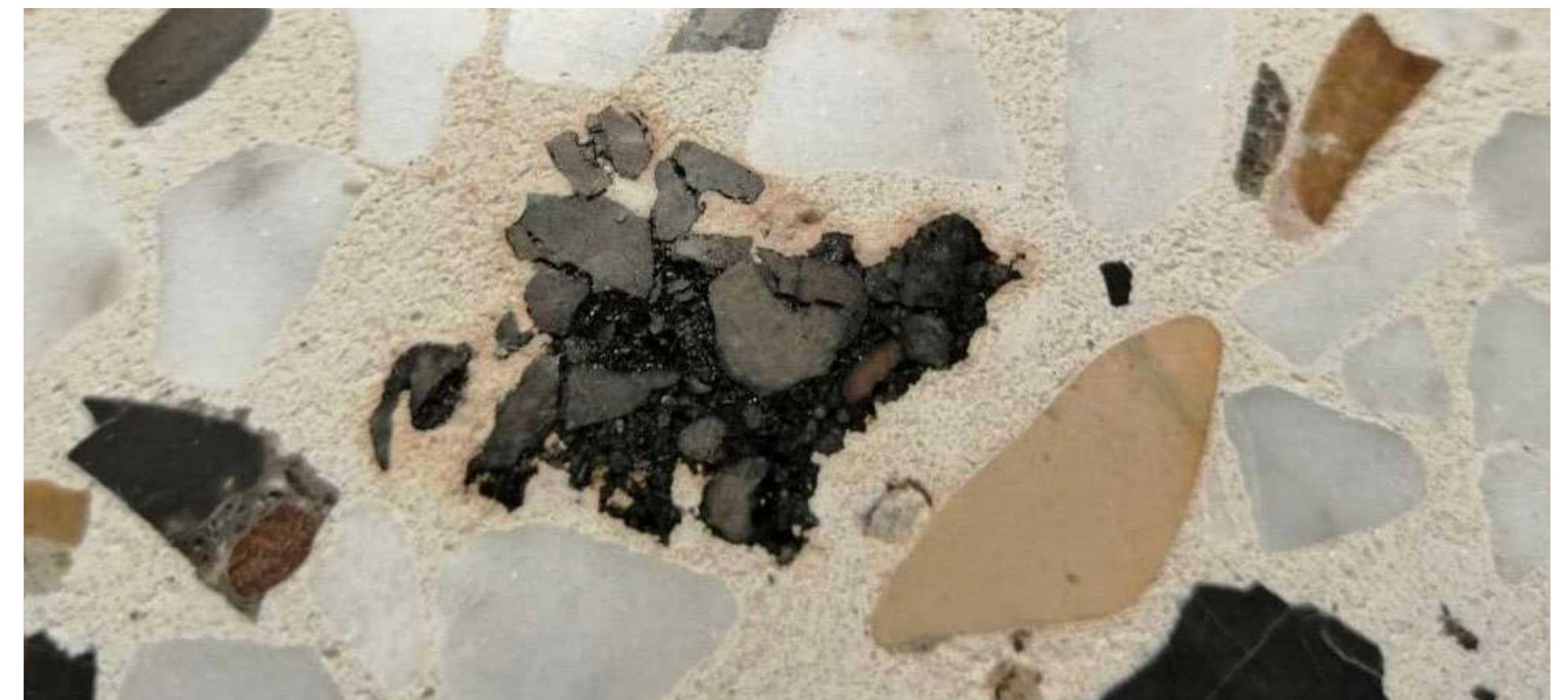
Verfärbung des Zements durch Bauschutt (Asphalt)
