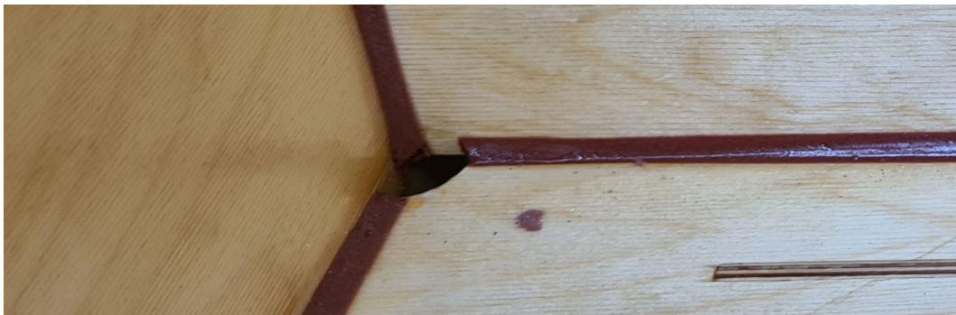
Abbildung 25: Abführen von stehendem Wasser mit Hilfe einer Bohrung in einer Innenecke
