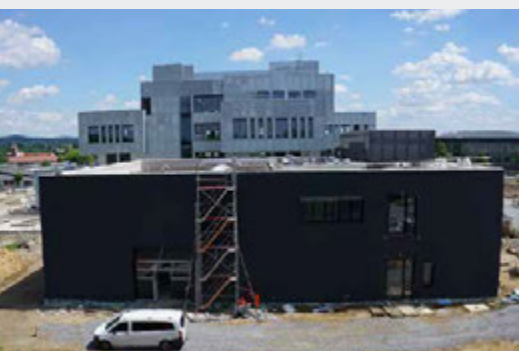
Der Bau der Lebensmittelabrik der Zukunft nähert sich der Fertigstellung. Aktuell werden auf dem Dach die Vorbereitungen für die Dachbegrünung getroffen.
